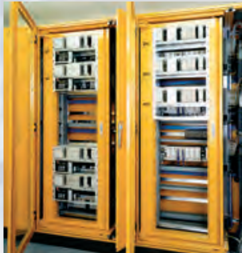
Steuerschrank zur Prozesssteuerung
