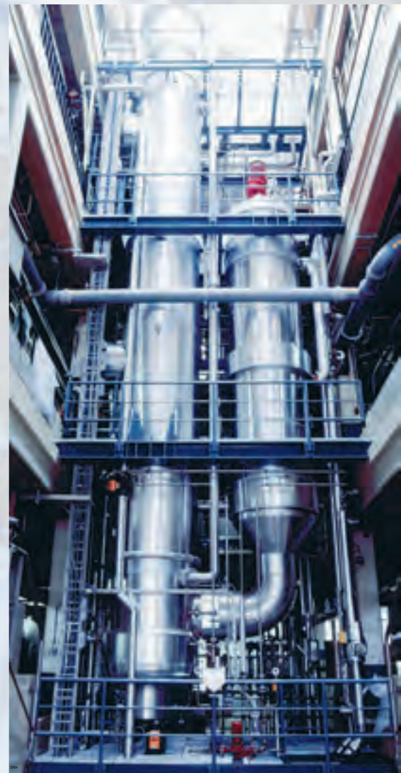
Rektifizieranlage (Vakuum 100 Pa)
