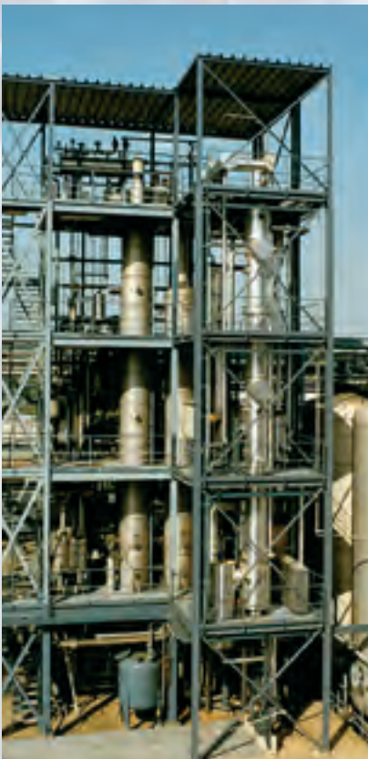
Rektifizieranlage für Lösungsmittel-Regeneration
