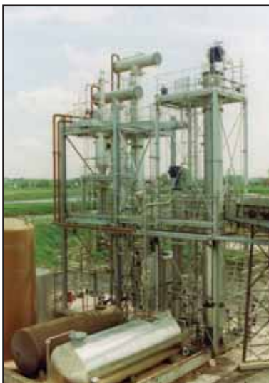
Flüssig-Flüssig Extraktionsanlage mit Extraktionsmittel-Regeneration
