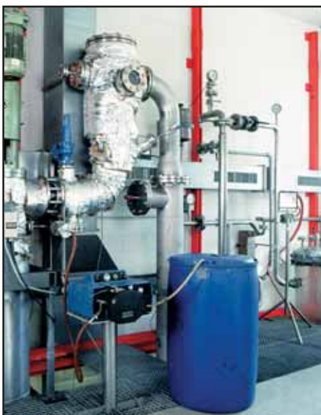
Versuchsanlage im S+P-Technikum
